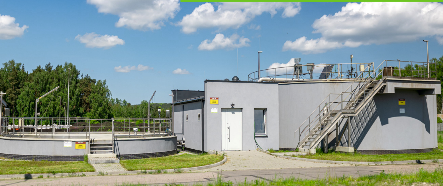
Zdj. Instalacja do podczyszczania odcieków z odwadniania osadów
